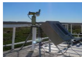
Figura 5: Fotómetro solar montado en el techo de la estación.
